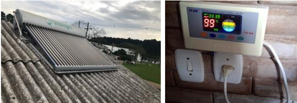
Figura 5: A) Aquecedor solar instalado no telhado da CPE. B) Controlador digital.
