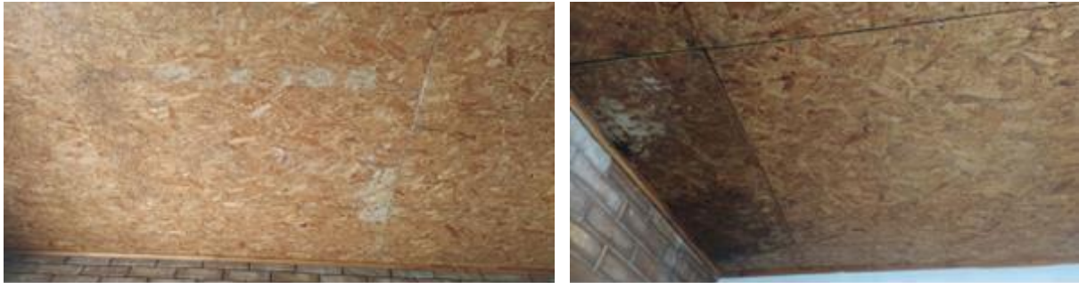
Figura 7: A) Placa OSB utilizada no forro. B) Ponto isolado com alteração na coloração da placa.
