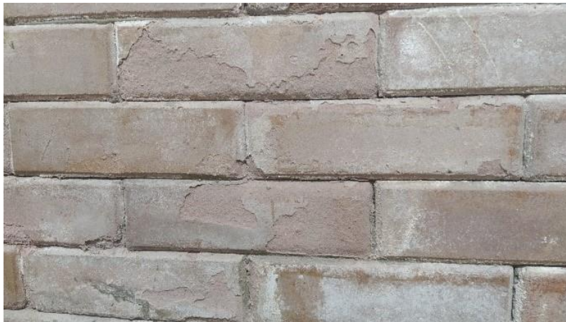
Figura 9: Parede interna com sinais de degradação.
