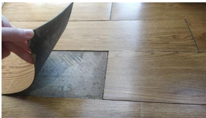
Figura 8: Descolamento do piso de PVC.
