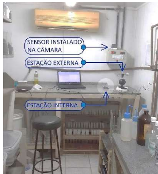
Figura 5: Câmara climatizada com localização dos sensores.
