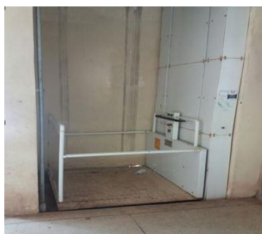
Figura 9: Elevador do Prédio ICH
